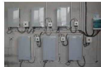
Onduleurs EARL. SOMMANT, Lamargelle (21) Source ADEME
